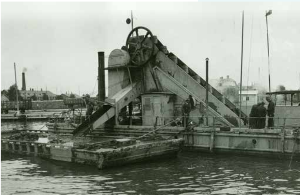
Maannousu ja Aurajoen tuoma liete vaativat jatkuvaa ruoppausta. Vuonna 1905 hankittu ketjuruoppaaja Karhu palveli Satamaa yli 80 vuotta. – Turun kaupungin arkisto
